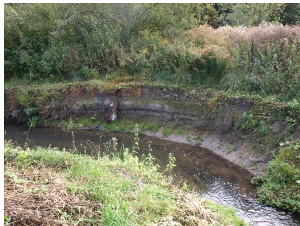
Fot.10 Niestabilizowany klif na prawym brzegu cieków.
