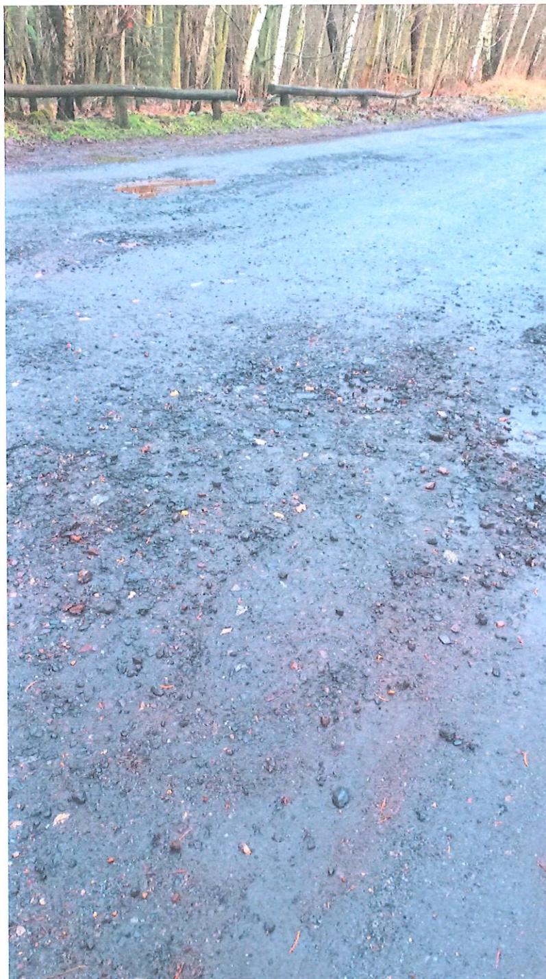
Fot. 2. Luźny destrukcyjny materiał pokrywający nawierzchnię ul. Bizantyjskiej
